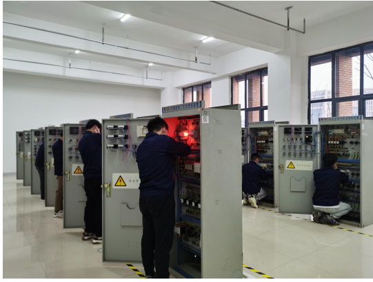
电工技能考核训练实训室
